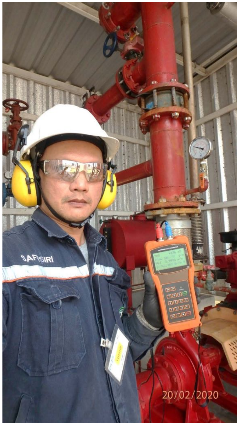
สามัญวิศวกรเครื่องกลผู้ตรวจ ทดสอบ ระบบเครื่องสูบน้ำดับเพลิง
