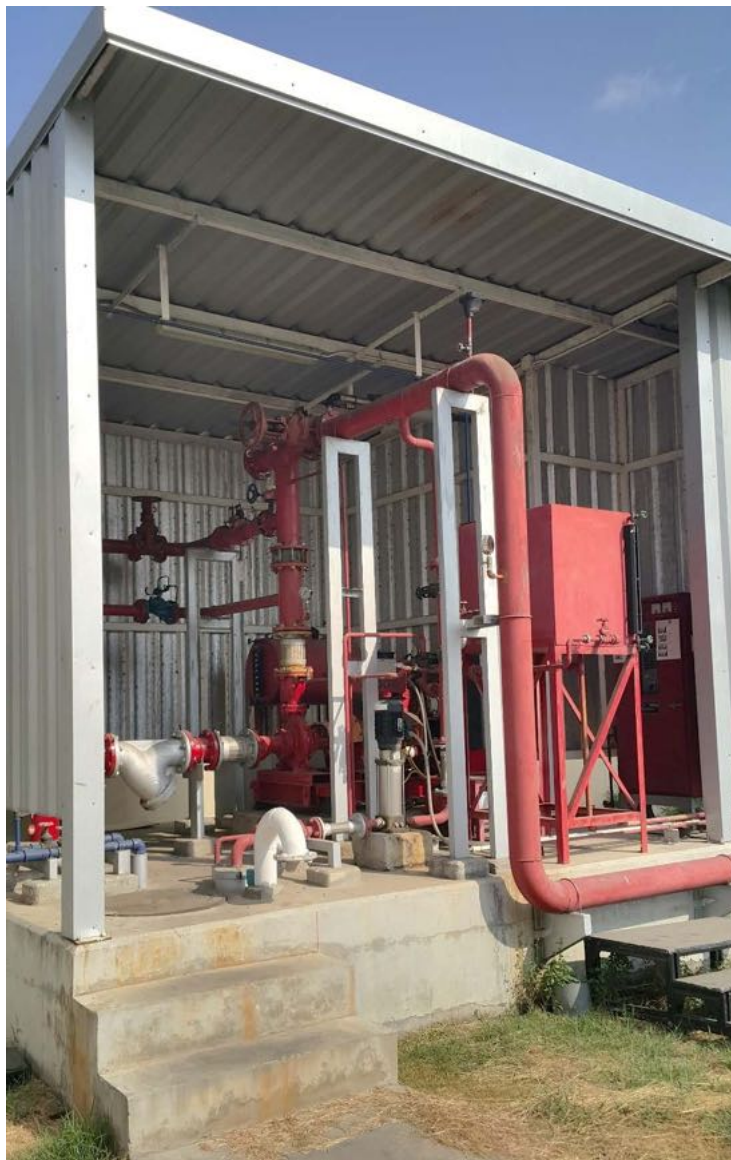
รูปถ่ายห้องเครื่องสูบน้ำดับเพลิง
