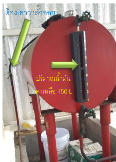
ถังพักน้ำมันเชื้อเพลิง
