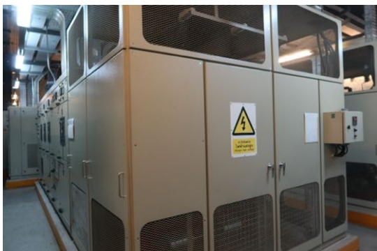
การตรวจสอบหม้อแปลง TR4 ขนาด 2000 KVA
