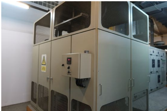
การตรวจสอบหม้อแปลง TR3 ขนาด 2000 KVA
