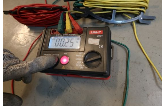
ค่าการต้านทานลงดิน 0.25 โอห์ม
