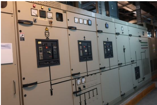
ลักษณะการติดตั้งตู้ MDB5
