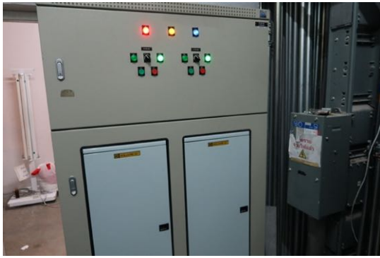
ลักษณะการติดตั้งตู้ย่อย PP3B/M2, LP3B/M2
