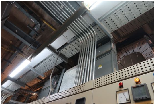
ลักษณะการเดินสายท่อร้อยสาย (conduit)
