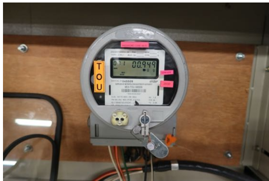
ตรวจสอบมิเตอร์วัดหน่วยไฟฟ้า
