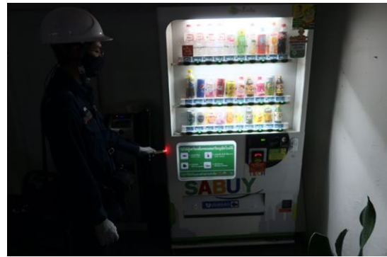
ตรวจสอบกระแสไฟฟ้าวของตู้กดน้ำอัตโนมัติ
