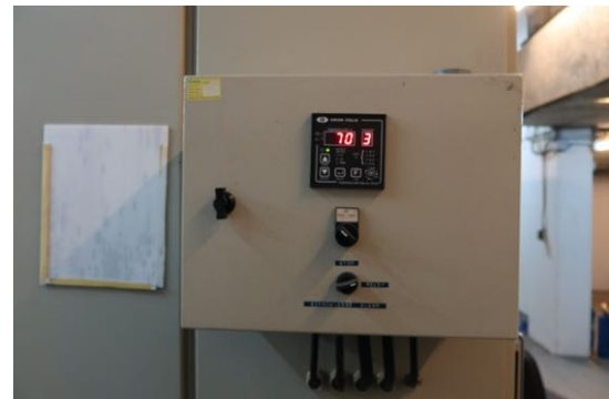
ระบบแสดงผลค่าอุณหภูมิหม้อแปลง
