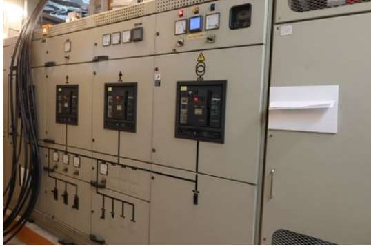
ลักษณะการติดตั้งตู้ MDB1
