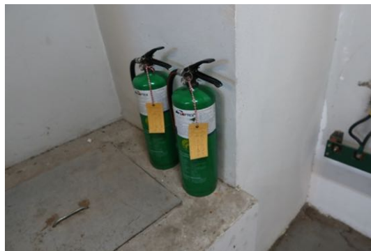
ถังดับเพลิง
