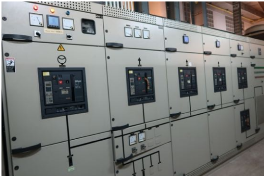
ลักษณะการติดตั้ง MDB3
