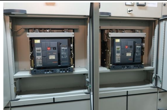
ตรวจเมนเซอร์กิตเบรกเกอร์ย่อย
