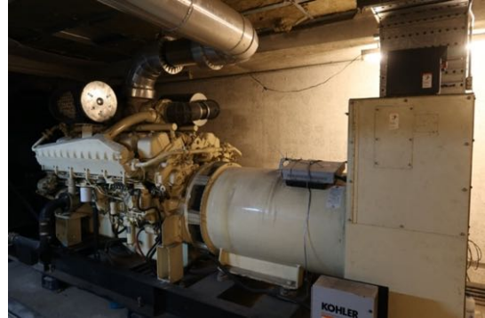
ตรวจสอบ Generator
