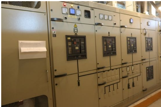
ลักษณะการติดตั้ง MDB2
