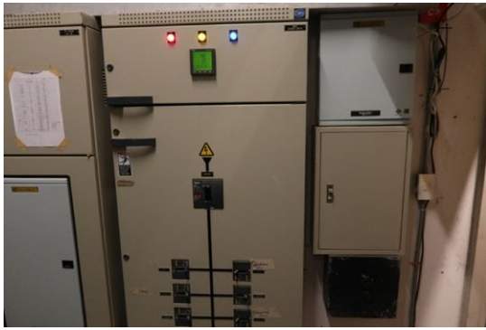
ลักษณะการติดตั้งตู้ย่อย DBFL(Food Loft)
