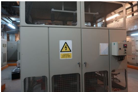
การตรวจสอบหม้อแปลง TR5 ขนาด 2000 KVA
