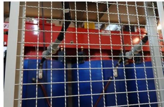
จุดต่อสายฝังแรงสูง
