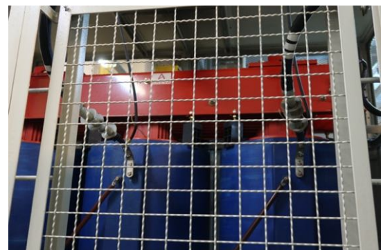
จุดต่อสายฝั่งแรงสูง
