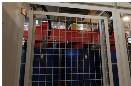
จุดต่อสายพ้งแรงสูง
