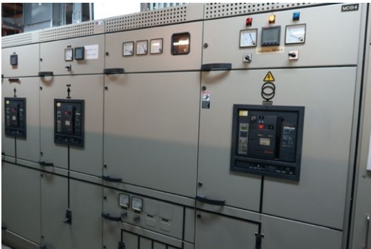
ลักษณะการติดตั้งตู้ MDB4
