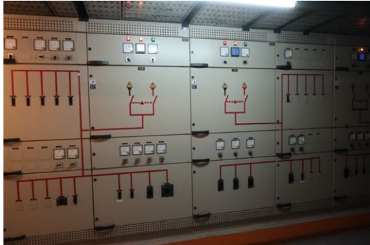
ลักษณะการติดตั้ง ATS
