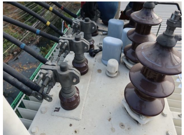
ภาพการตรวจสอบจุดต่อสาย
