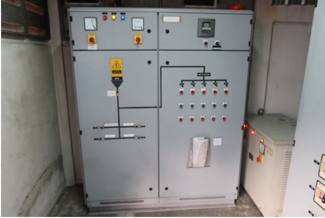
ภาพสภาพตู้ก่อนทำความสะอาด
