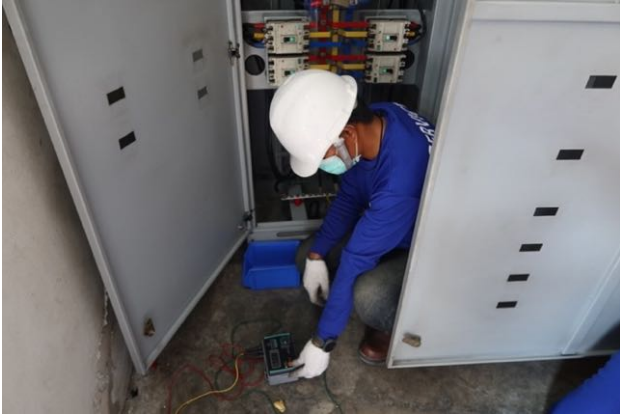
ภาพการตรวจสอบค่าความต้านทานการต่อลงดิน
