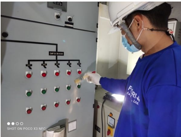
ภาพใช้แปรงปัดบริเวณฝาตู้
