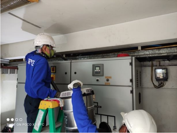
ภาพทำความสะอาดด้วย BLOWER บริเวณแผงหลังตู้
