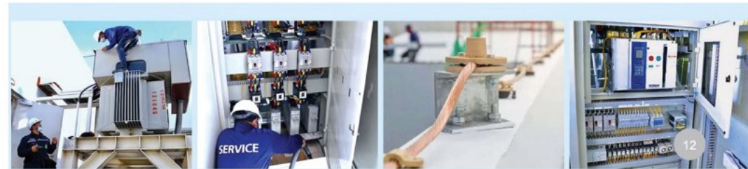
PM หม้อแปลงไฟฟ้า Distribution Transformers PM ตู้ควบคุมไฟฟ้า MDB Main Distribution Board PM ตรวจสอบสายล่อฟ้า, ตรวจสายกราวด์ Lightning Rod PM อุปกรณ์ไฟฟ้าอื่นๆ Electrical control equipment
